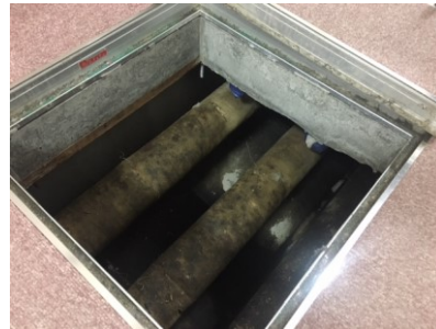
廊下下に埋められた配管設備
