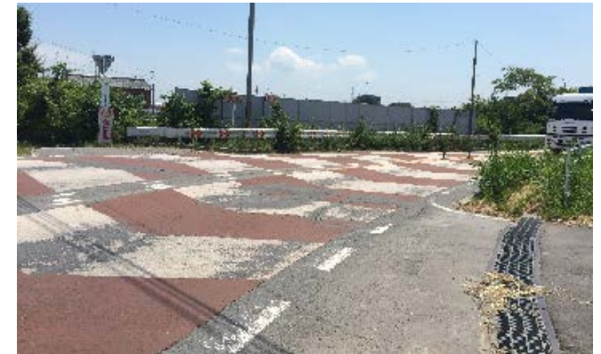
路面損傷が激しい国道 356 号（印旛郡栄町布太）
